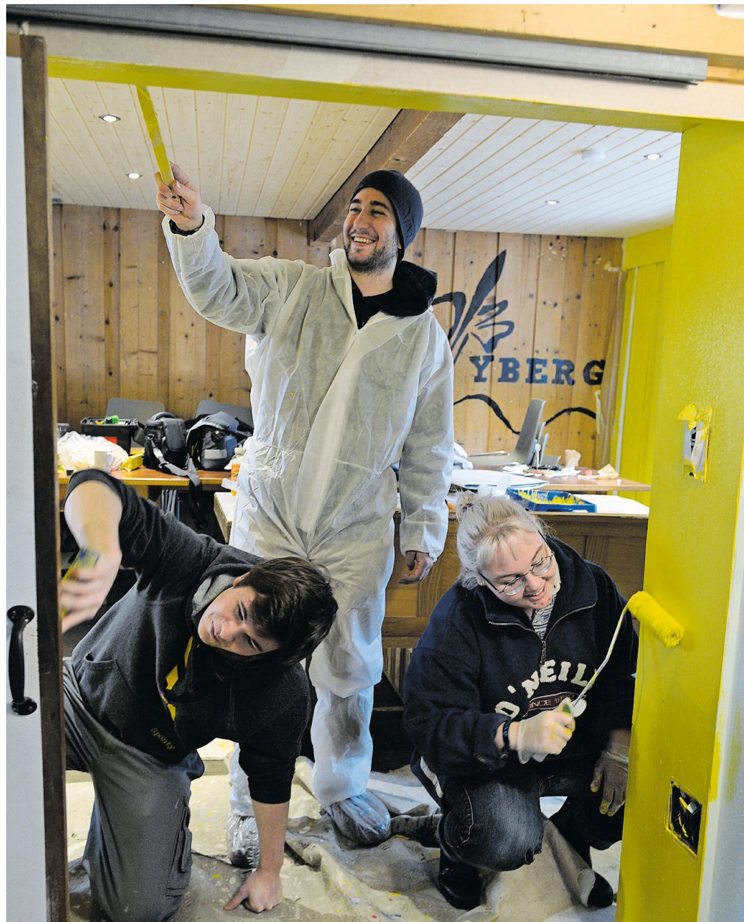
Die Pfadileiter Roman Vonwiller, Camilo Scherrer und Corinne Bischof beim Neustreichen des Aufenthaltsraums der Pfadihütte Yberg. Bild: Hansruedi Kugler
